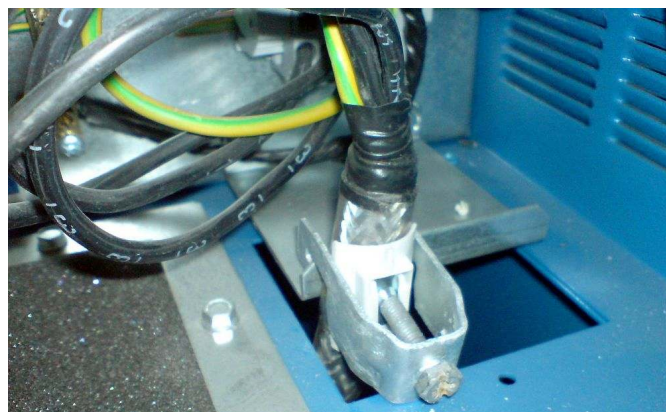
Kabelanslutning i styrsåp. Korrekt utförande.
