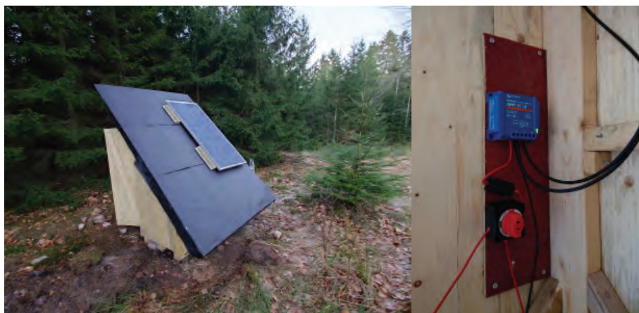
FIGUR 3: Till vänster: Solcellerna är på plats på boden. Till höger: Solcellsregulator samt avskiljare för batterierna.
