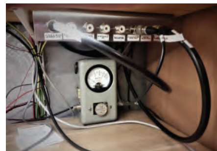
BILD 2: Antennväxeln drifttagen. Viktigt att dokumentera vilken radio som finns bakom respektive kontakt. Detta för att det skall bli enkelt att använda och att inga misstag görs.
