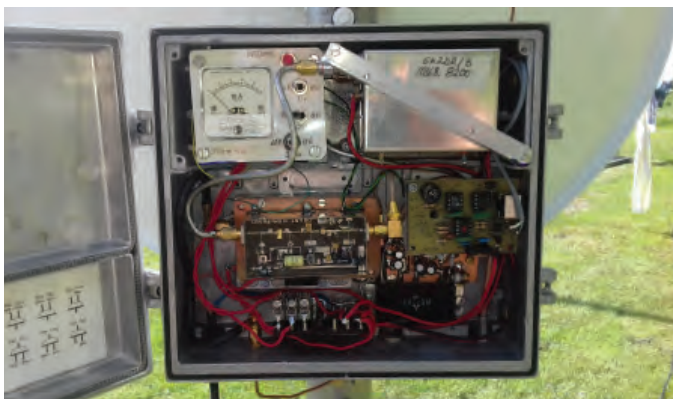
RADIOFYRARNA FÖR 23 CM OCH 3 CM i testdrift, innan städning av kablage före slutligt driftsättning. Fyrarna uppe i högra hörnet, drivsteg och slutsteg för 3 cm nere till vänster och nere till höger slutsteg för 23 cm.
