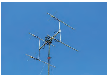
Och deras vackra antenninstallation.
