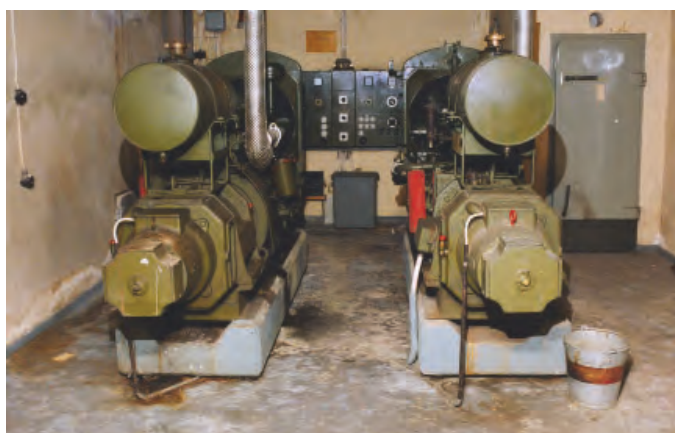
Två kraftaggregat för strömförsörjning.
