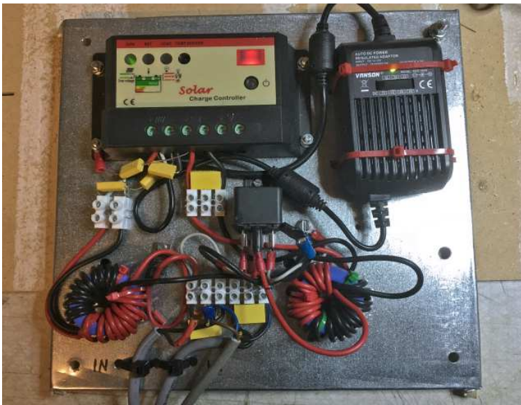
Laddningsenhet med regulator och omvandlare.
