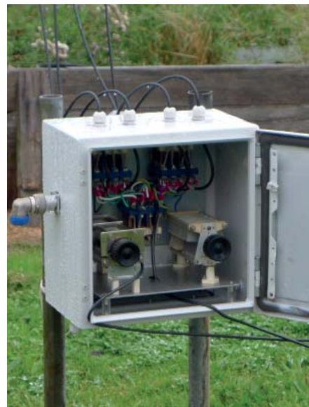
Antennenboxen/fasboxen som kopplar ihop de fyra vertikala dipolerna och antennen är för 30-metersbandet.
