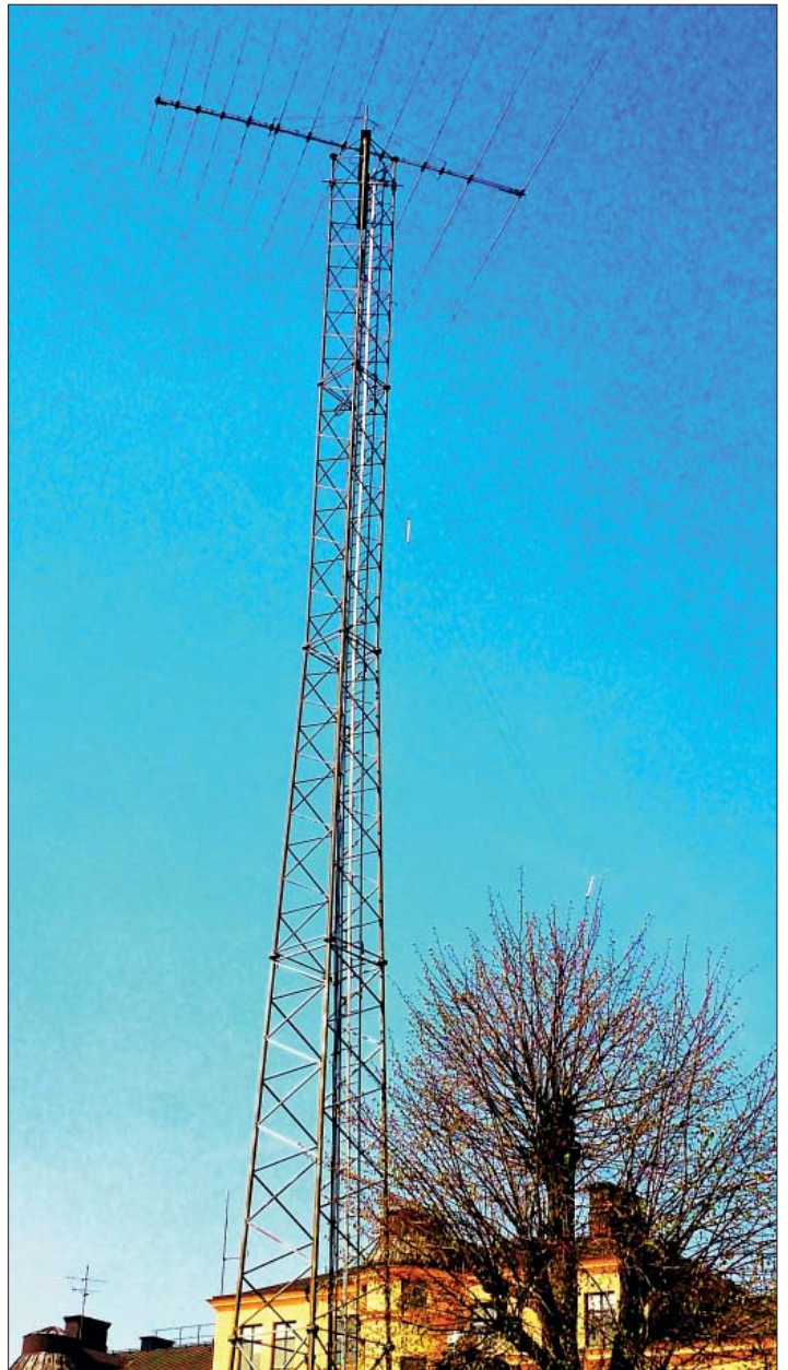
Den logperiodiska riktantennen såg jag på sin nya plats, vid mitt besök i Karlskrona tidigare i år.
