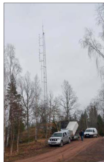
Nu är repeatern i Gåskulle i luften igen, bilden visar mast och teknikbod.
