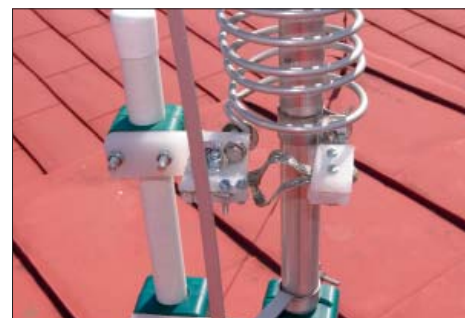
Den nya flexibla anslutningen av spolen mot antennröret.
