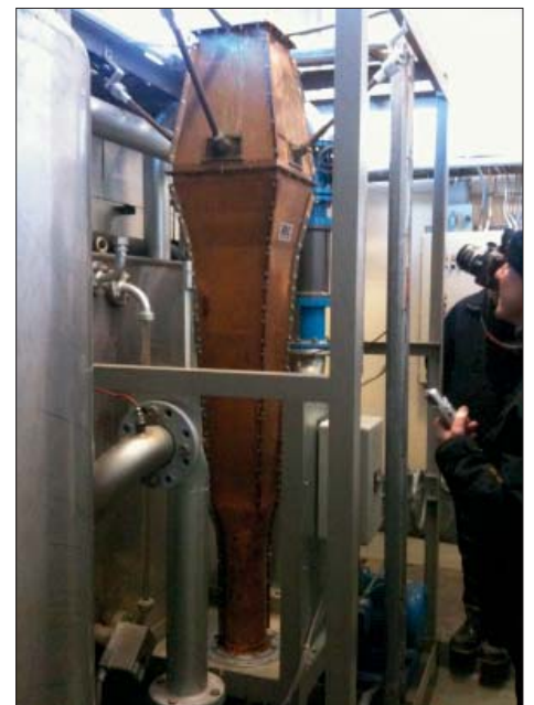
Sodafyllt konstlast vid Hörby KV. Vid rätt temperatur håller konstlasten impedansen 50 Ohm och tål 2,5MW.
