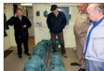
Styraggregaten för magnetisering av stora generatorer med 0,3 Hz.
