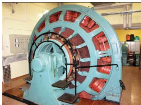
Stora generatorn för avmagnetisering. Installerades första gången för hundra år sedan på Stockholms Spårvägar.
