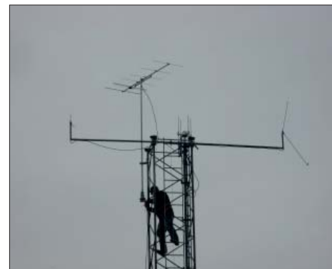
Antennmontering för NAC144.
