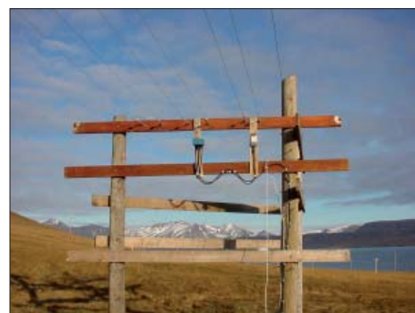
Del av matarledningarna hos TF4M, totalt har 10 km tråd monterats. Foto: www.tf4m.com
