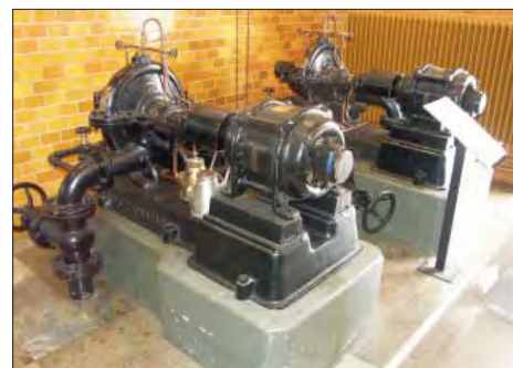
Kraftiga dubblerade kylvattenpumpar tar vatten från en utomhusbassäng.
