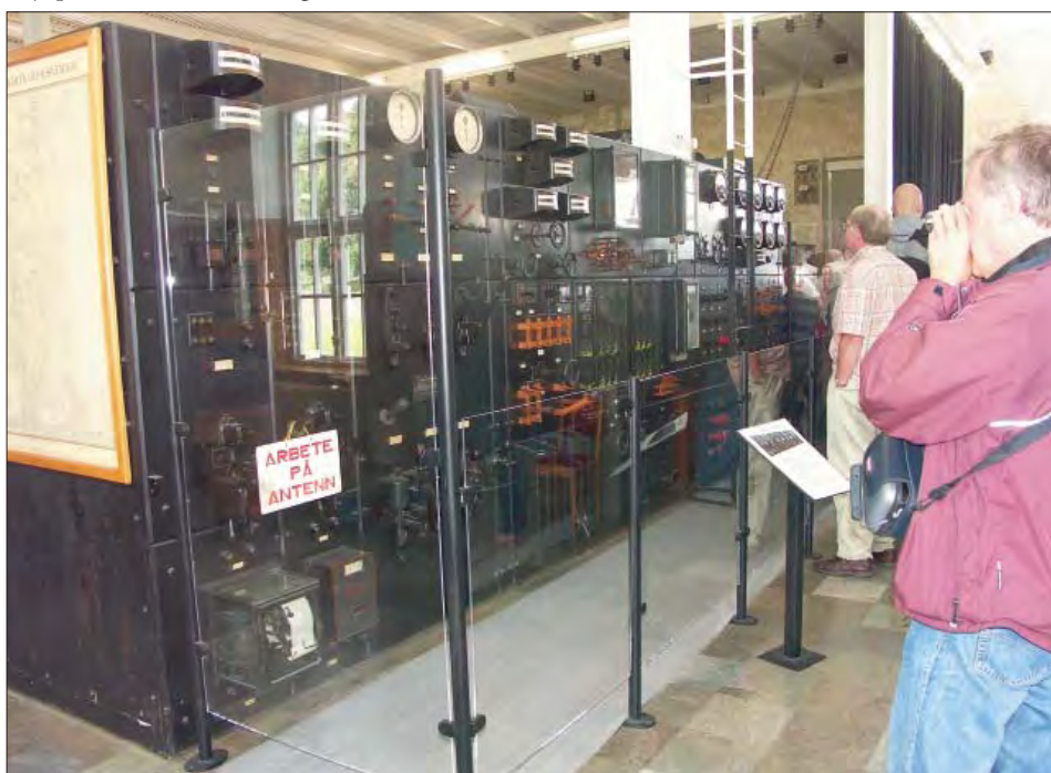
Den imponerande manöverpanelen.
