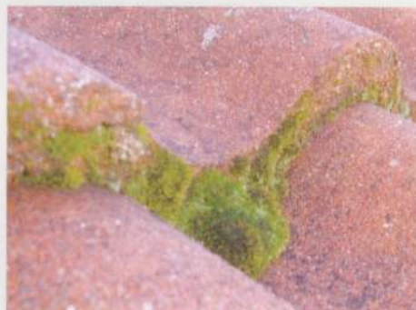
Mossa på taket.
